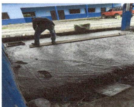
Foto 3: Trabajo en la reparación de torta de cemento para que no se entre agua al corredor
